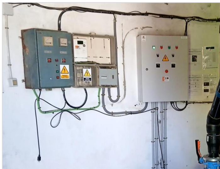
Imagen 31. Cuadro eléctrico del depósito de copa.
