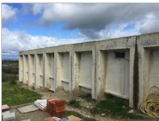
Imagen 22. Vista general del depósito de regulación de Peraleda de la Mata.
