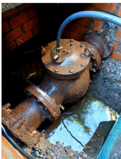
Imagen 18. Válvula reguladora de presión fuera de uso ubicada en la salida de la EBAP de Peraleda de la Mata.
