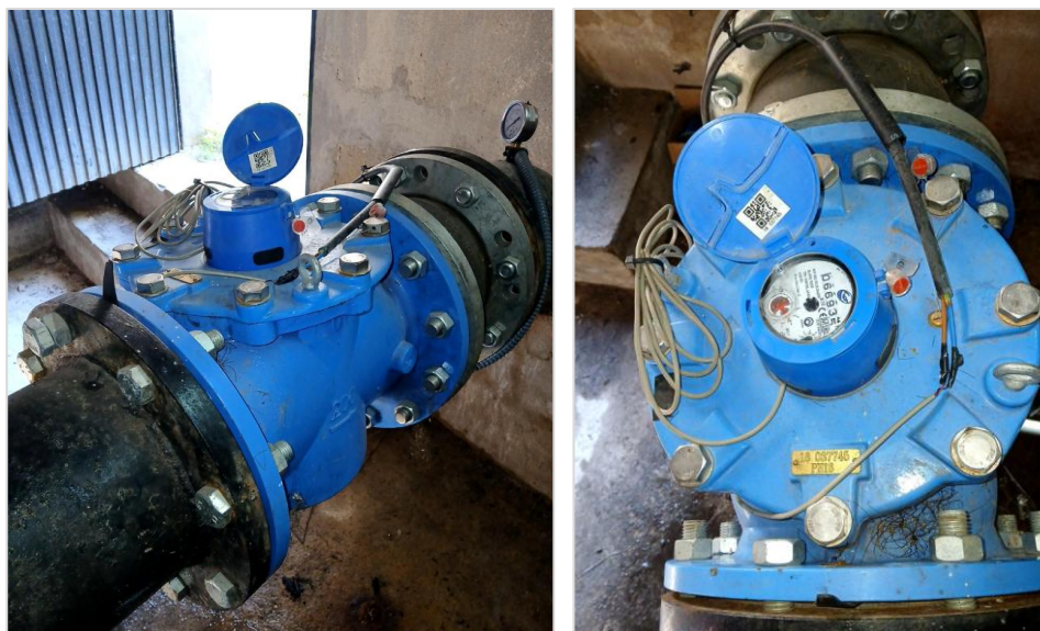
Imagen 17. Caudalímetro de Geconta WP-SDC PLUS DN200 en la impulsión del grupo de presión de la EBAP.
