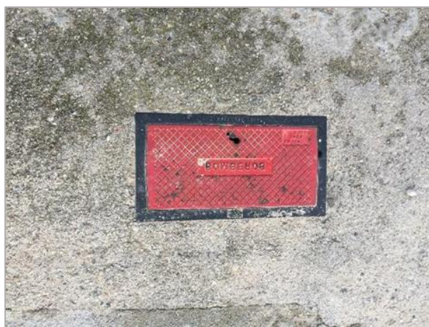
Imagen 37. Tipología de hidrante.
