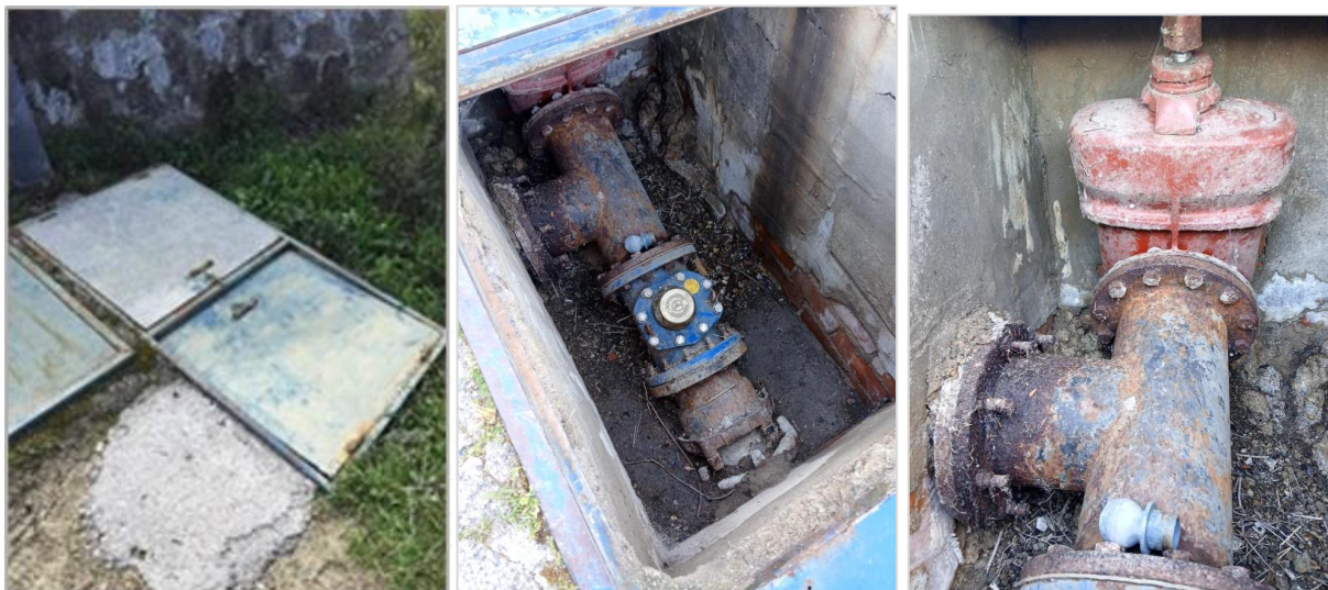
Imagen 21. Arqueta de contabilización y reparto a depósitos ubicada en Peraleda de la Mata.
