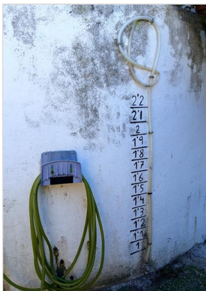
Imagen 29. Visor de nivel del aljibe en el depósito de copa.
