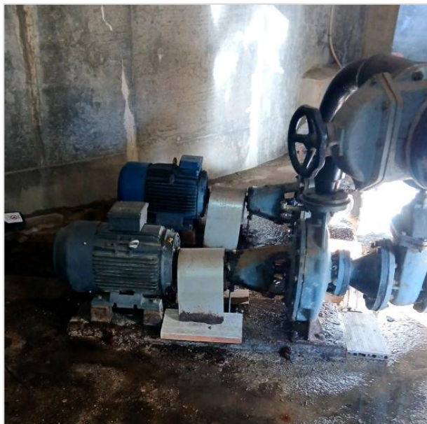
Imagen 16. Sistema de impulsión EBAP Peraleda de la Mata.
