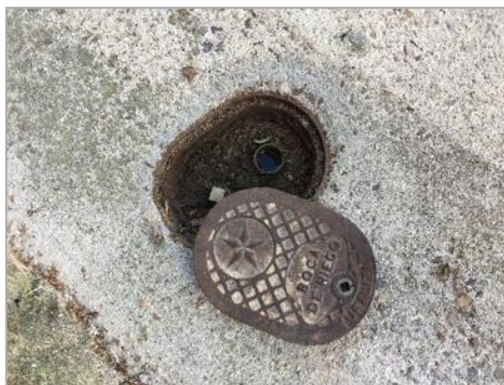
Imagen 36. Tipología de boca de riego presente en el municipio.
