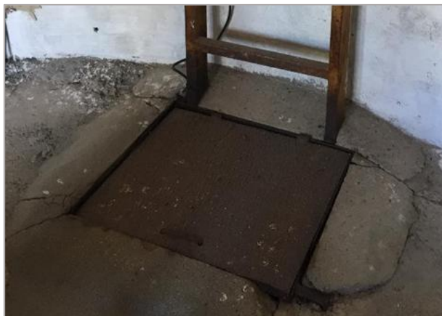
Imagen 44. Tapa de registro del vaso de aspiración del depósito de copa
