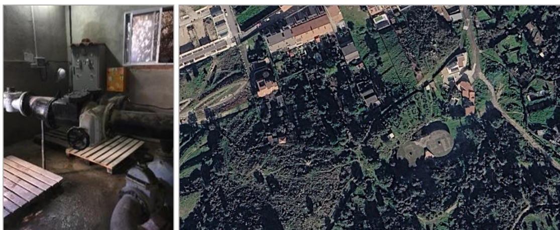
Imagen 49. Inundación de la sala de bombeo de los depósitos de cola de Navalmoral de la Mata y ubicación en planta de los mismos.
