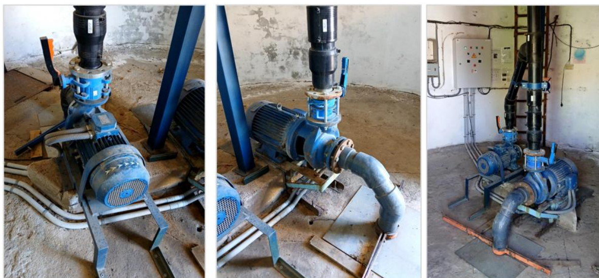
Imagen 26. Grupo de presión del aljibe al vaso superior del depósito de copa de Peraleda de la Mata.
