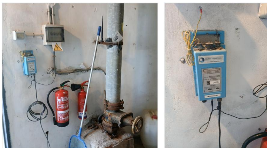
Imagen 28. Válvula y caudalímetro de salida del depósito de copa.
