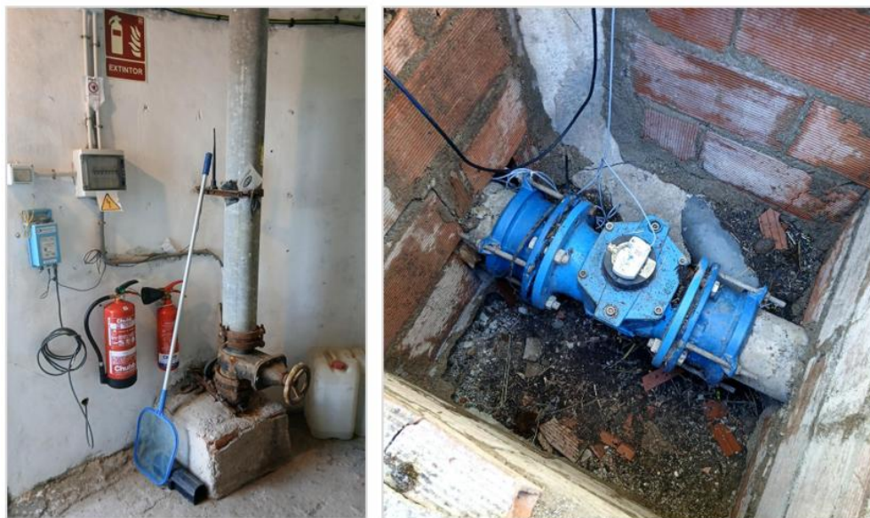
Imagen 27. Válvula y caudalímetro de salida del depósito de copa.
