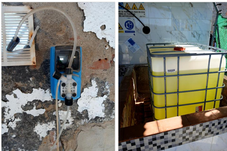
Imagen 19. Sistema de desinfección existente en el depósito regulador de Peraleda de la Mata.
