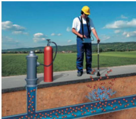
Figura 13. Equipo de detección con gas.
